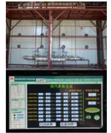
内蒙古金陶公司电锅炉系统
