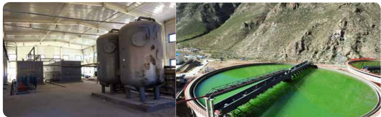
公司新建污水处理厂处理设备
