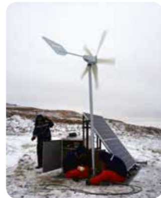
内蒙古矿业公司尾矿坝风光互补监控系统
