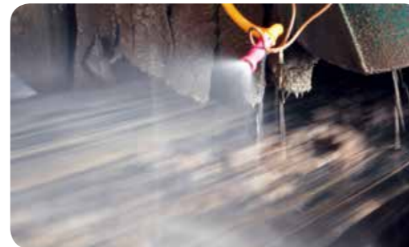
嵩县金牛公司破碎车间湿式除尘设备
