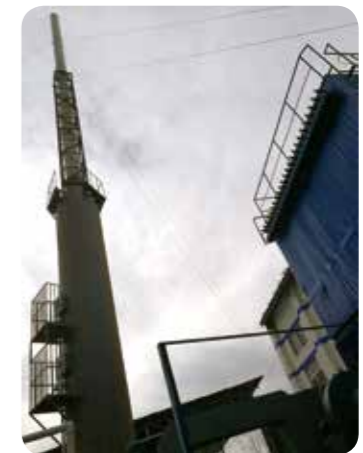
陕西鑫元科工贸公司暖气锅炉脱硫除尘设施
