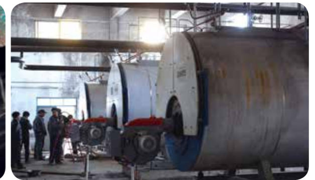
河北金厂峪公司更换环保锅炉
