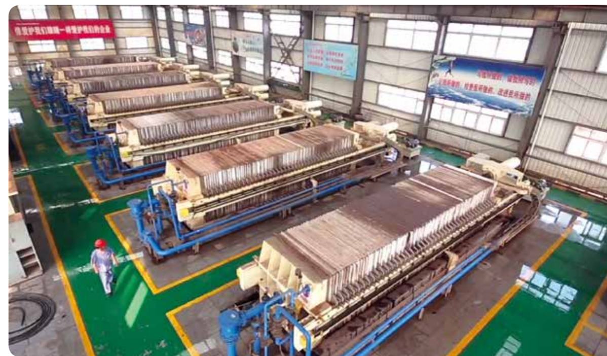
尾矿压滤设备
