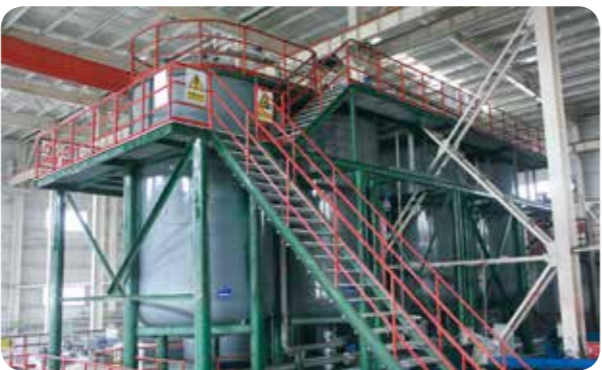
循环液除杂设备
